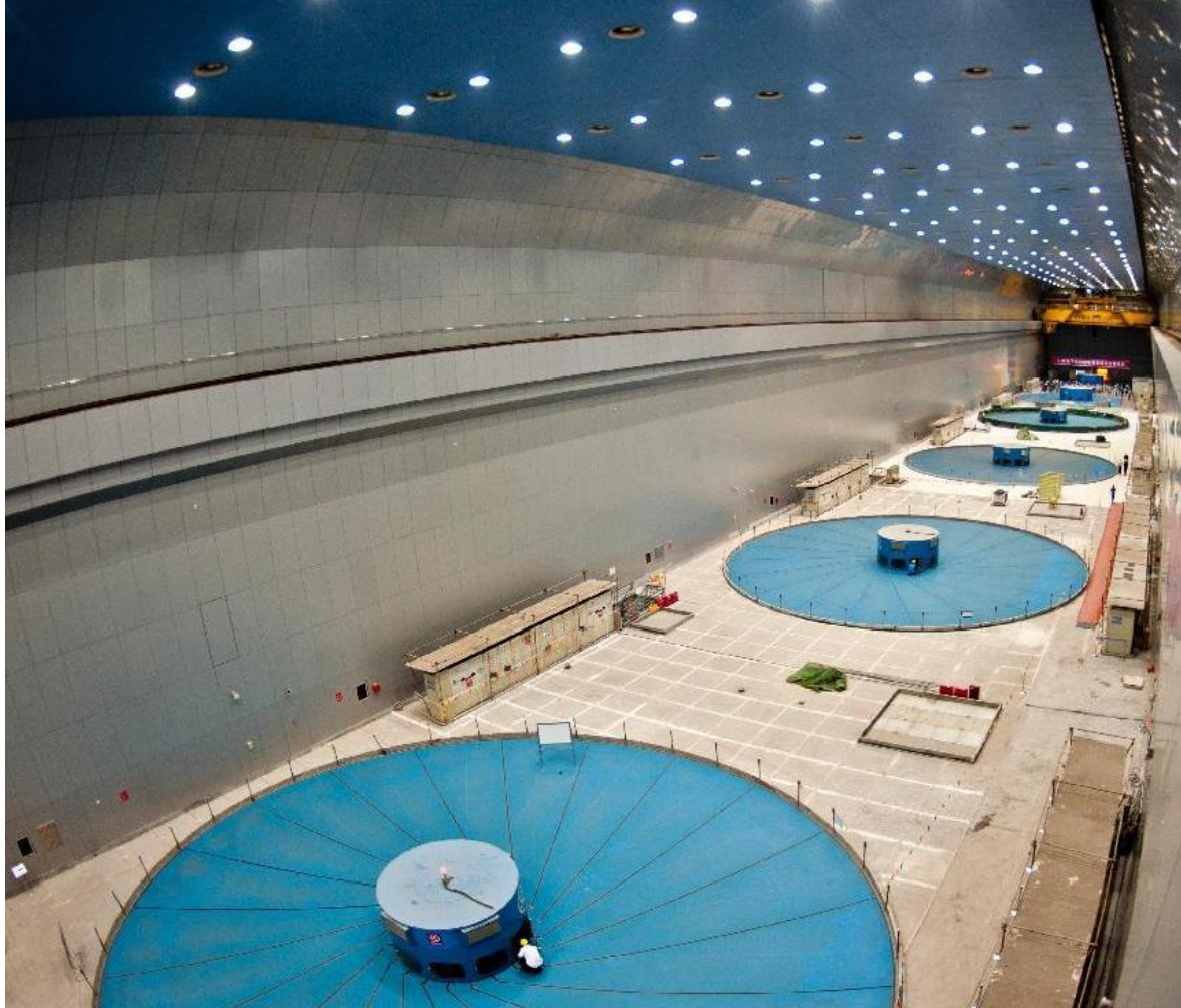
Presa de las Tres Gargantas – China 700MW Generator Hall (26)
