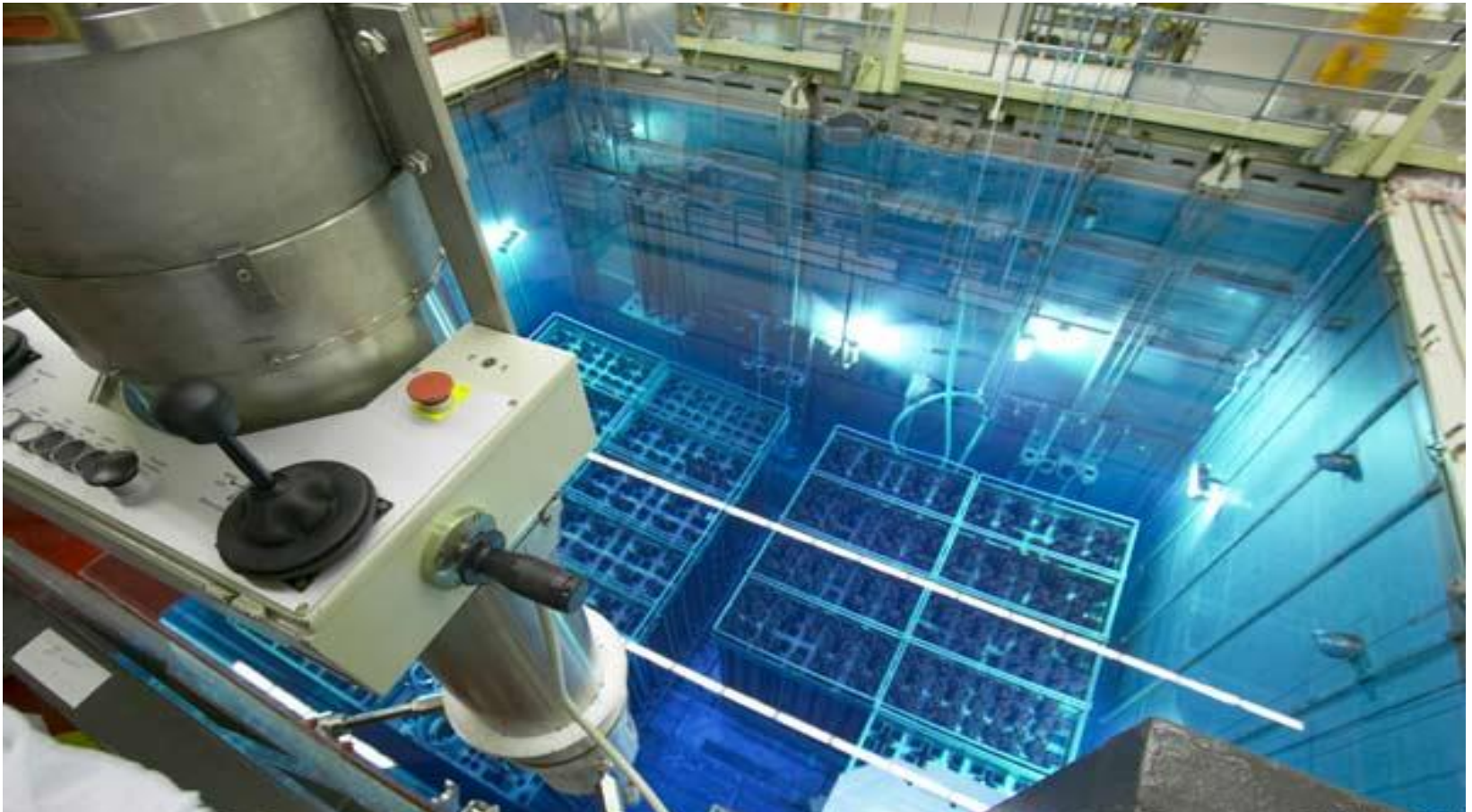
Piscina de almacenamiento de combustible
